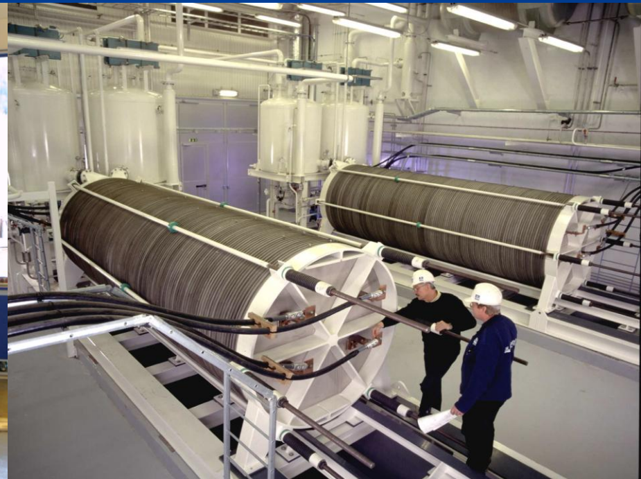
Norsk Hydro Electrolysers 2 MW each
