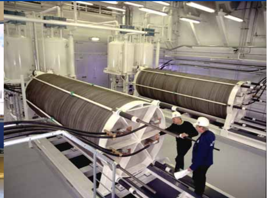
Norsk Hydro Electrolyzers 2 MW each
